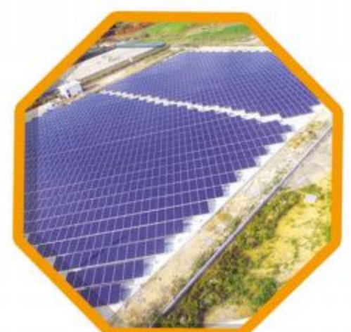
CLIENTE PRIVADO 1 MW
