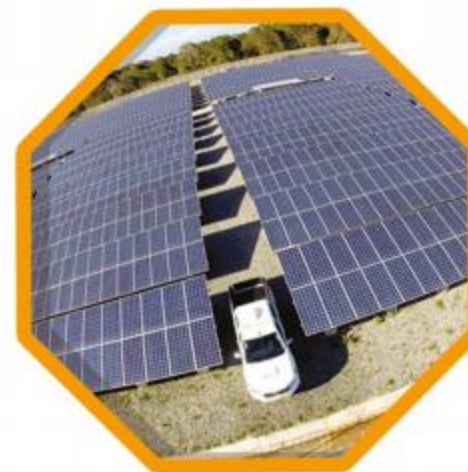
CLIENTE PRIVADO 1.5 MW
